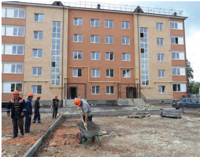
Строительство 45-квартирного дома по программе переселения граждан из аварийного жилья в Уруссу.
