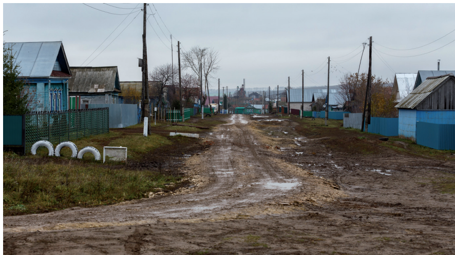
Новая дорога прошла испытание проливными дождями.
