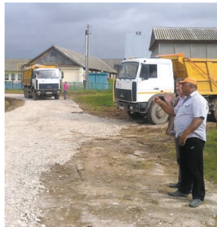
В д. Чутай Нурунерского сельского поселения Балтасинского района на средства самообложения отремонтирована улица.
