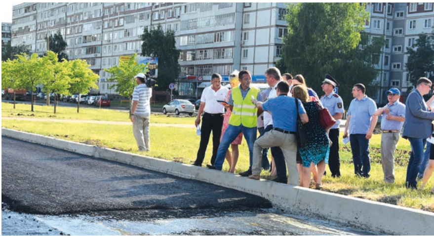
В процессе строительства проводимые работы находились под постоянным контролем руководителя исполкома Набережных Челнов Наиля Магдеева.
