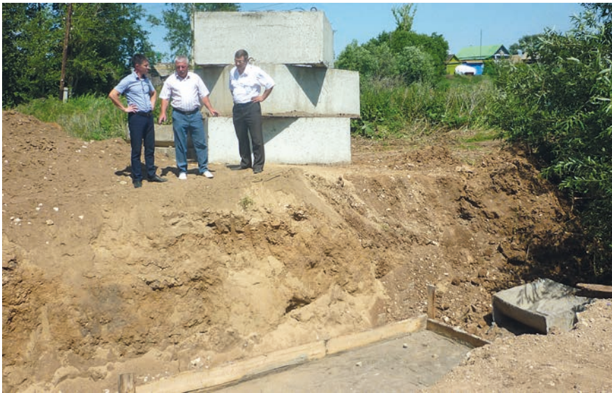
То, что дело идет, видно невооруженным глазом — дно оврага аккуратно залито бетоном, рядом лежат бетонные блоки.
